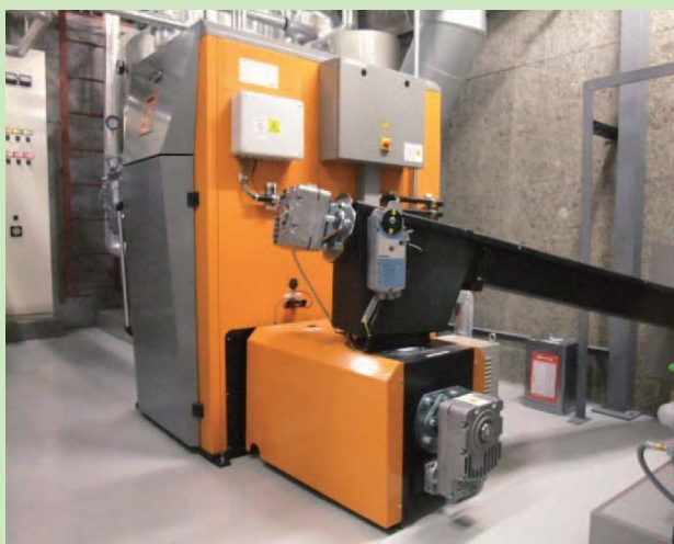
ペレットボイラー（滝上町）
